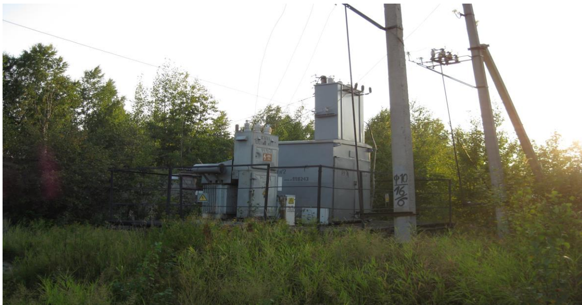
Трансформаторная подстанция п. Высокого // Фотография сделана 09.08.2020 г.
