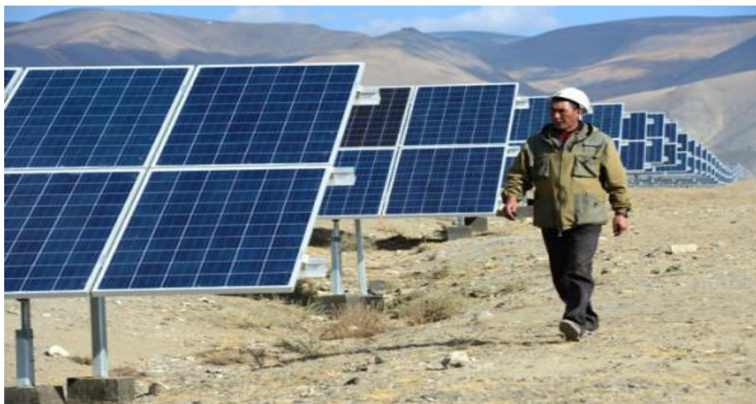
Кош-Агачская солнечная электростанция (СЭС), расположенная в Республике Алтай // https://neftregion.ru/chistaya-energiya/gelioenergetika-v-rossii
